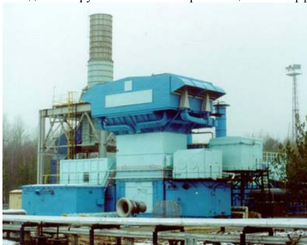
Рис. №1 КВОУ для газоперекачивающего агрегата ГПА-16 «Нева». Первая ступень – прямоточные мультициклоны, вторая ступень – карманные фильтры. 1990-е годы, ОАО «ВНИИтрансмаш».
